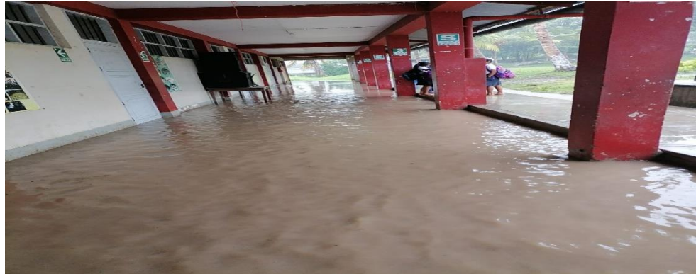
PASADIZO COMPLETAMENTE INUNDADO
